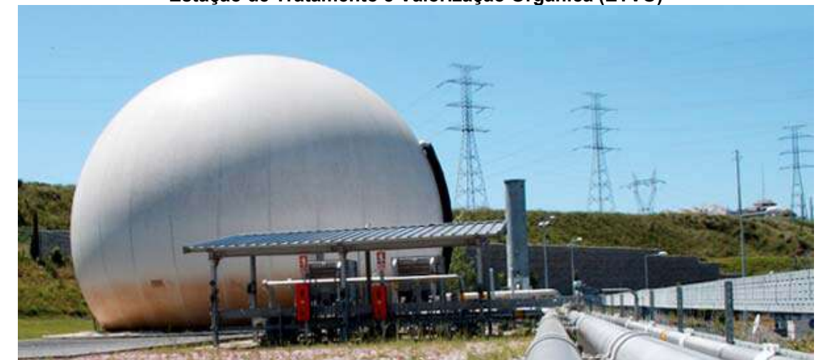
Estação de Tratamento e Valorização Orgânica (ETVO)
