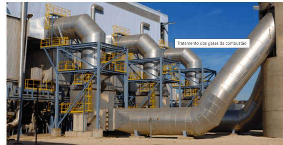
Tratamento dos Gases da Combustão
