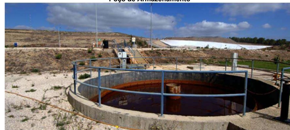
Poço de Armazenamento
